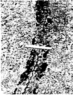
(L): Vết nứt đơn thẳng, chiều rộng vết nứt < 13 mm, không lún.
