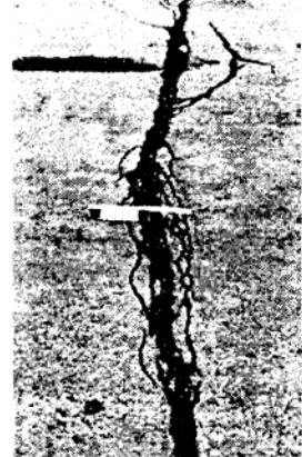
(H): Vết nứt có chiều rộng lớn và nứt thứ cấp nghiêm trọng, chiều rộng cả vết nứt chính và nứt thứ cấp > 100 mm.
