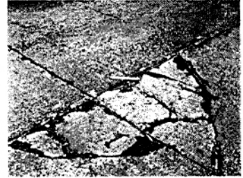
(H): Vết nứt lớn, nứt thứ cấp rộng > 50 mm, có hiện tượng lún, bong tại vị trí nứt.
